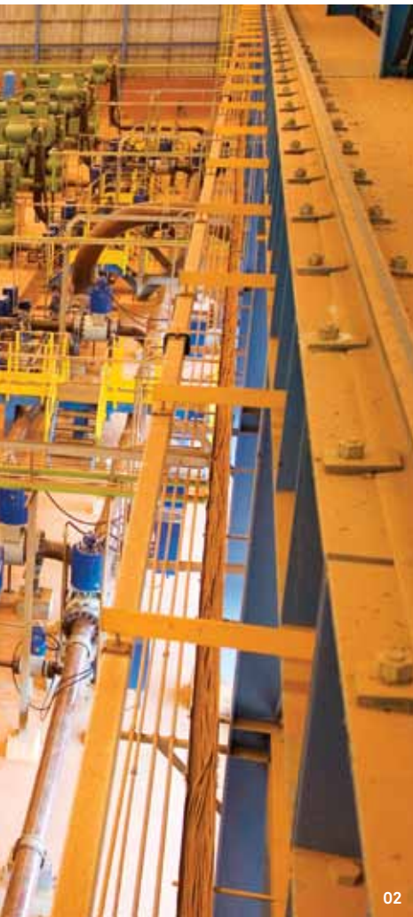
01 Los Bronces Copper Ore Pipeline, Chile
