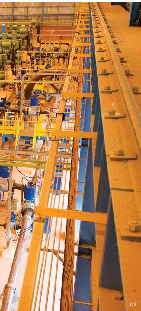
01 Los Bronces Copper Ore Pipeline, Chile
